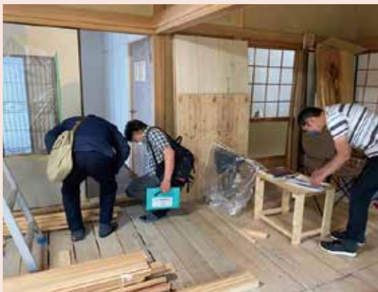
fig.4 被災住居長期居住者への訪問アドバイス：建築士とケースワーカーが被災住宅を訪れてDIYによる修繕の提案等を行っている(提供：中村陽二氏)
