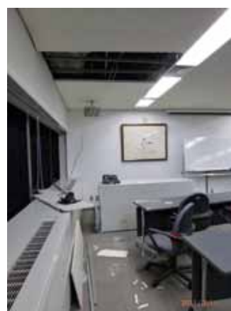
写真1 天井板の落下
