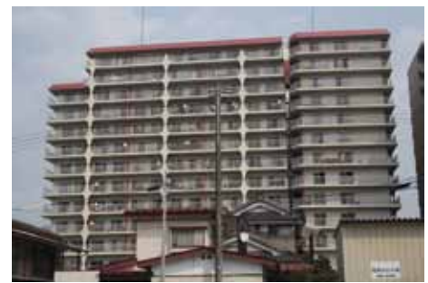
写真3 高層マンションの傾斜(仙台市若林区卸町)
