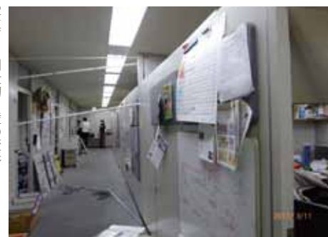
写真2 (転倒防止の仮支え中) 間仕切り壁の変形
