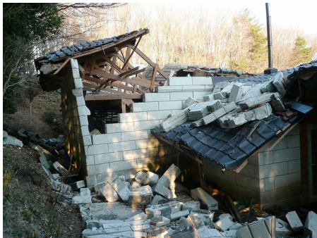
大谷石蔵の倒壊 栃木県那須烏山市 [撮影:稲山正弘]
