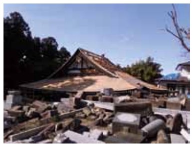
社寺本堂の倒壊(栃木県塩谷郡高根沢町)〔撮影 稲山正弘〕
