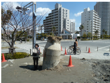
液状化による190cm程度のマンホール浮き上がり 千葉県浦安市明海地区 [撮影:岸田忠大]
