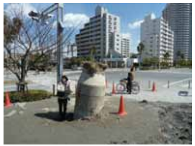
液化化による一九〇センチ程度のマンホール浮き上がり(千葉県浦安市明海地区)〔撮影 岸田忠大〕
